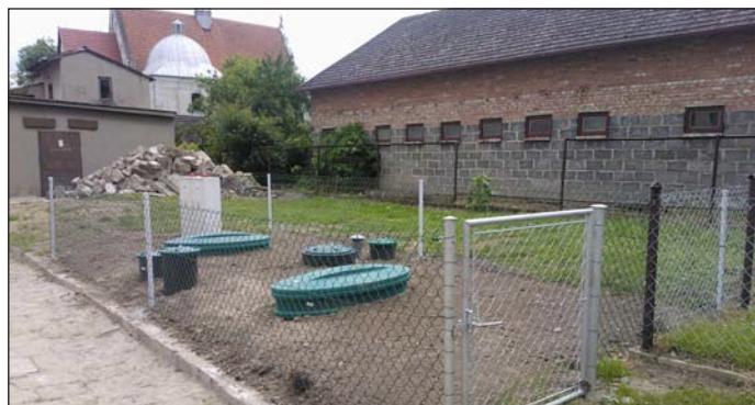
Oczyszczalnia przy Ośrodku Zdrowia w Opatowcu
